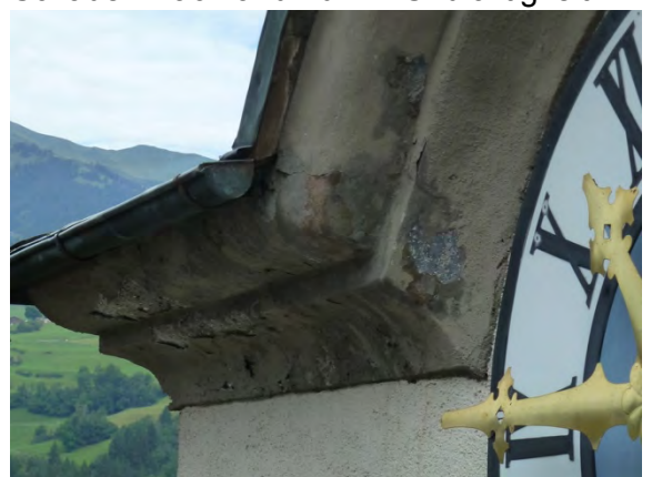
Schäden Dachrand Turm
