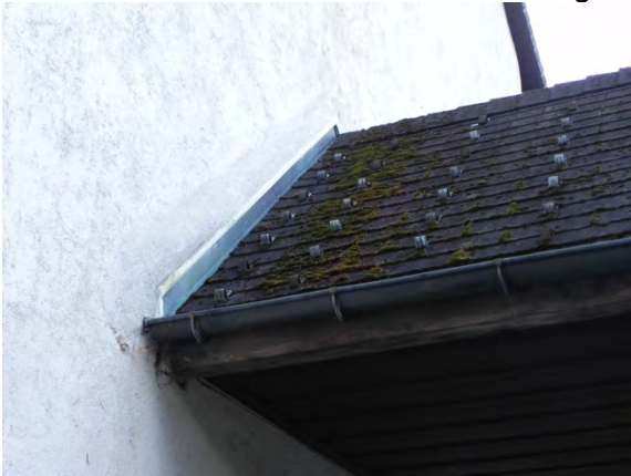
Vordach Nordwestseite / Moos
