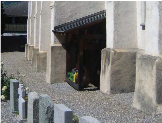
Sockel Südwestseite / Witterungsspuren
