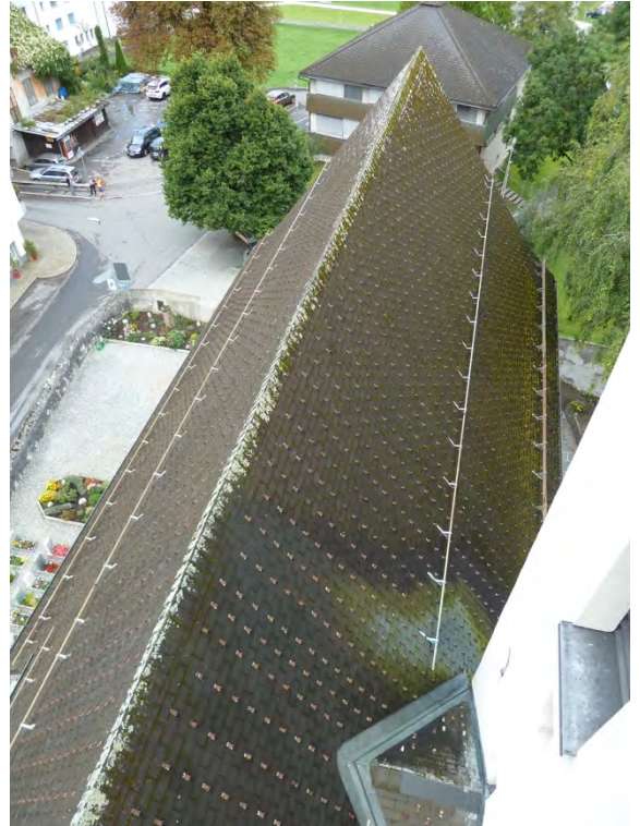
Eindeckung Schiff / Verunreinigung, Moos
