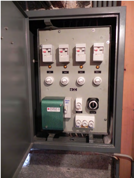
Elektr. Unterverteilung Turm
