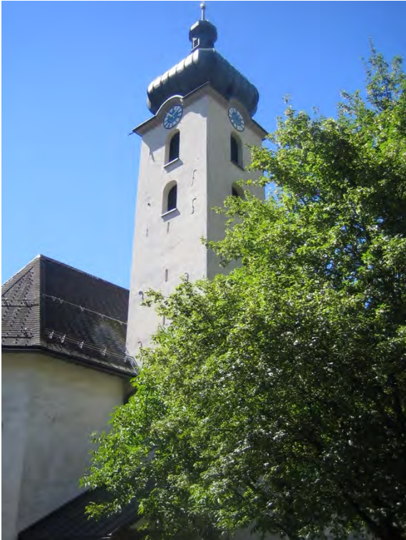
Turm Südostseite / Schäden Eindeckung
