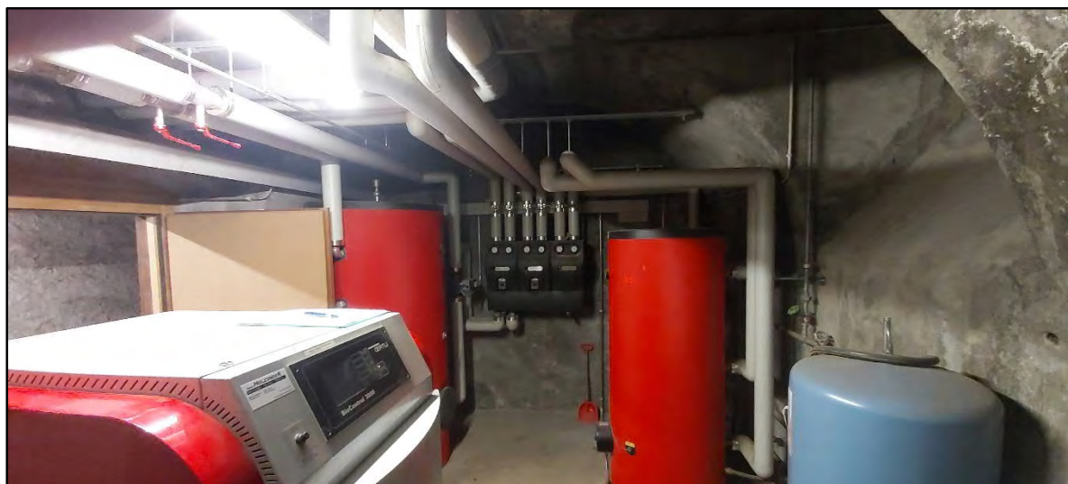
Abbildung 2: Pelletsheizung 45 kW im Pfarrhaus
