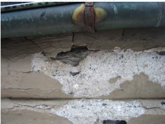
Verputzabplatzungen Dachrand Turm
