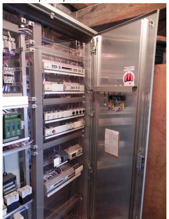
Steuerungsschrank Lautwerk / Uhr
