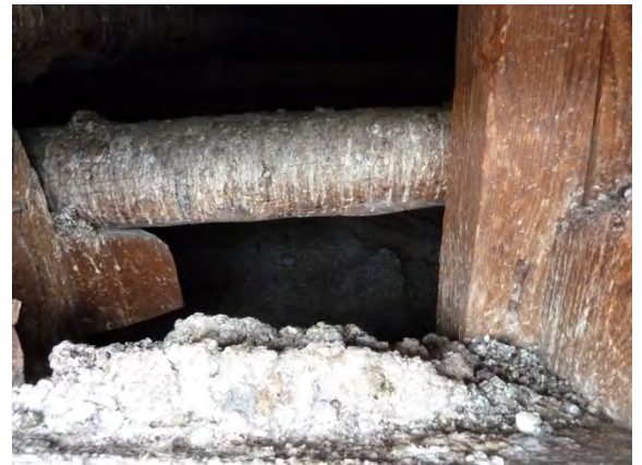
Turmzwiebel / Verunreinigung (Tauben)
