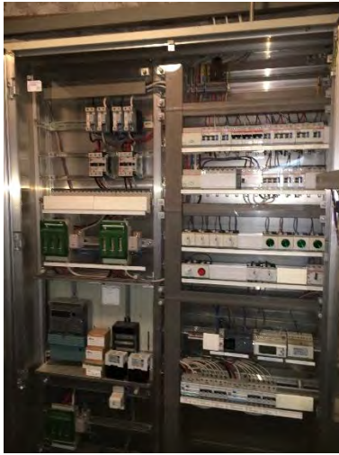
Hauptverteilung in aktueller Ausführung
