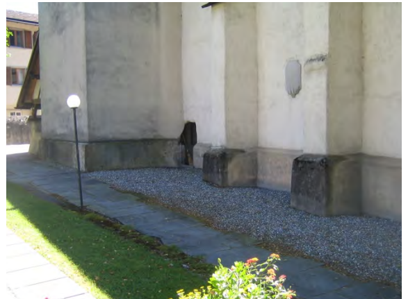
Sockel Nordostseite / Witterungsspuren
