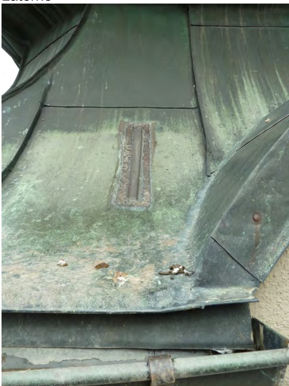
Flickstelle Dach Turm
