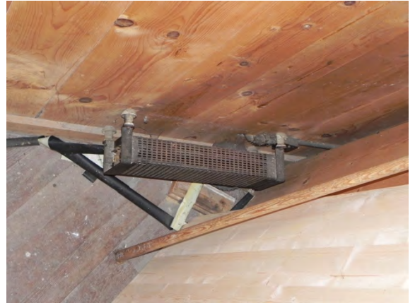
Heizkörper hinter Orgel
