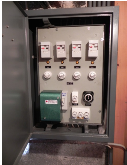
Elektr. Unterverteilung Turm
