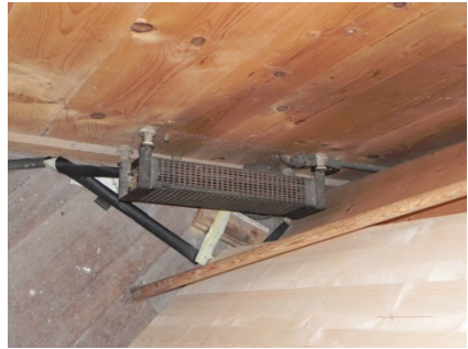
Heizkörper hinter Orgel
